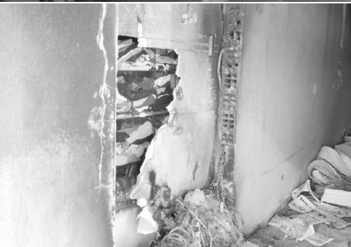
Toda a infraestrutura do prédio sofreu danos e o local ficou interditado
